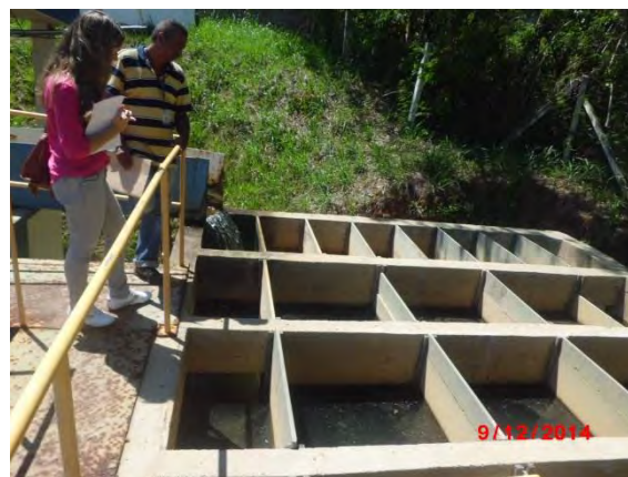
Figura 17: Caixa de entrada, Calha Parshall e floculador Fonte: Conen
