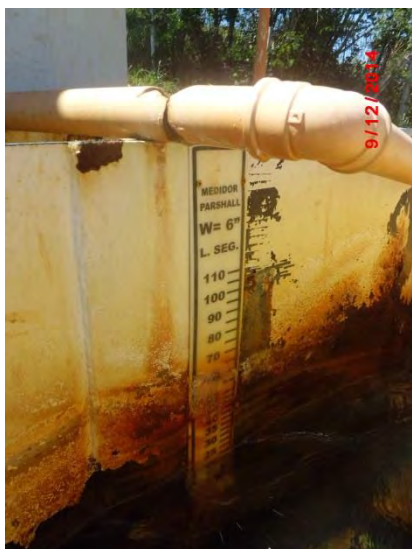
Figura 16: Nível de vazão de chegada Fonte: Conen
