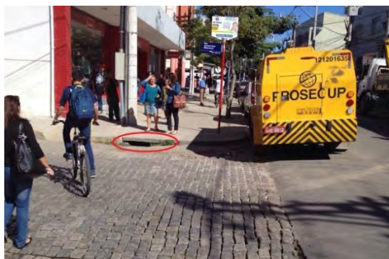
Figura 34: Boca de Lobo Fonte: Conen
