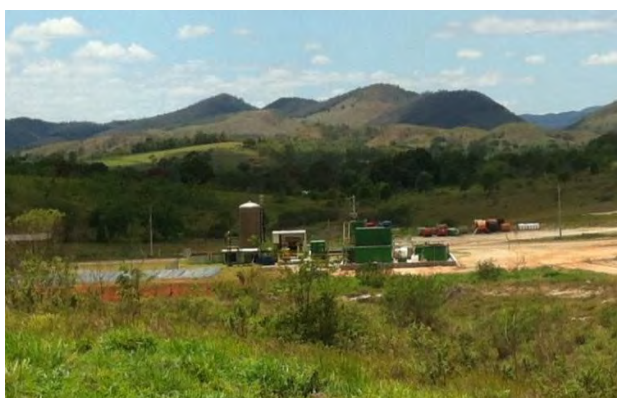
Figura 66: Estação de tratamento de chorume Fonte: Conen
