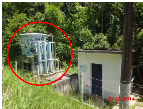
Figura 21: Filtro no Poço Manoel Ribeiro Fonte: Conen
