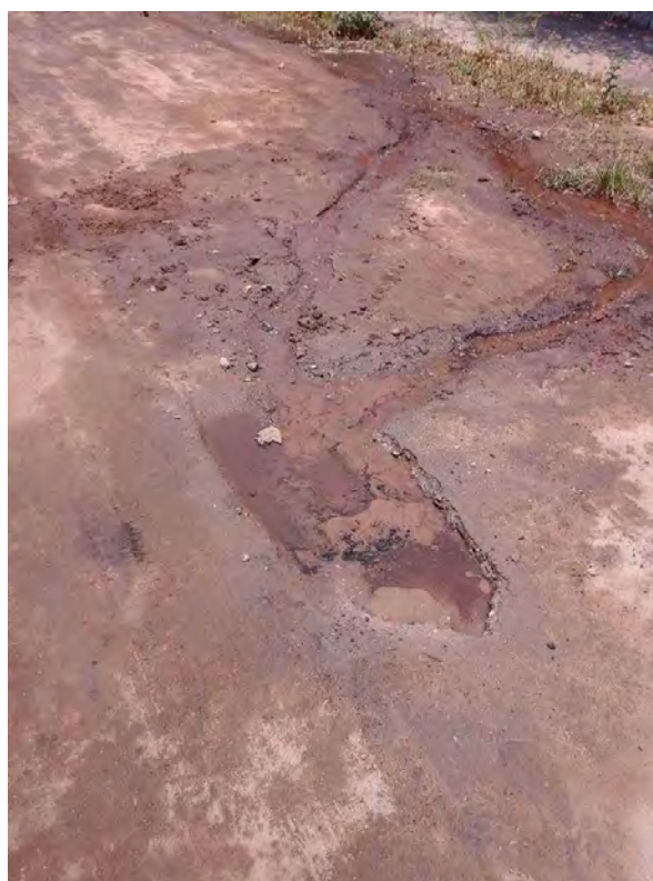
Figura 25: Vazamento na Rua 14 do bairro de São Bento. Fonte: Grupo Saneamento Básico de Maricá – Participe! ( Facebook )
