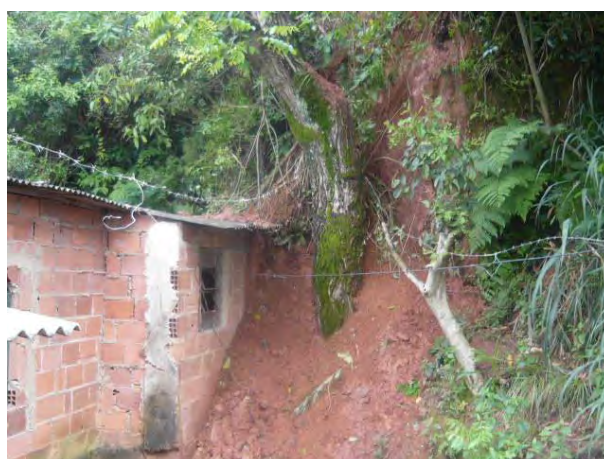
Figura 49: Ocupação irregular Fonte: Defesa Civil de Maricá
