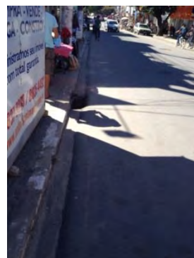
Figura 35: Sarjeta e de boca de lobo Fonte: Conen
