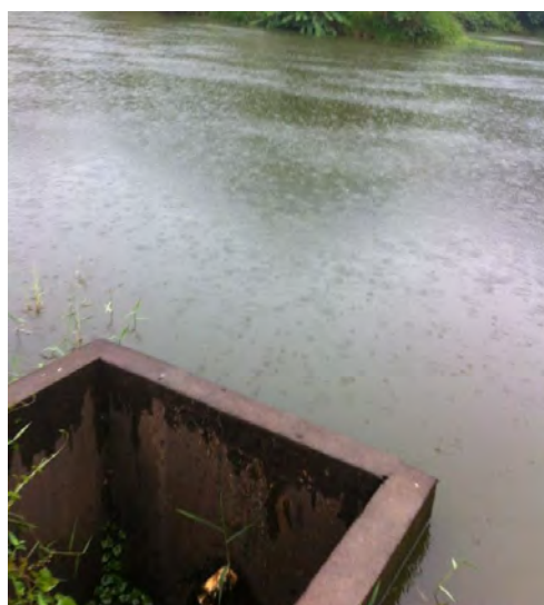
Figura 9: Barragem ilegal estabelecida em parte do rio Ubatiba
