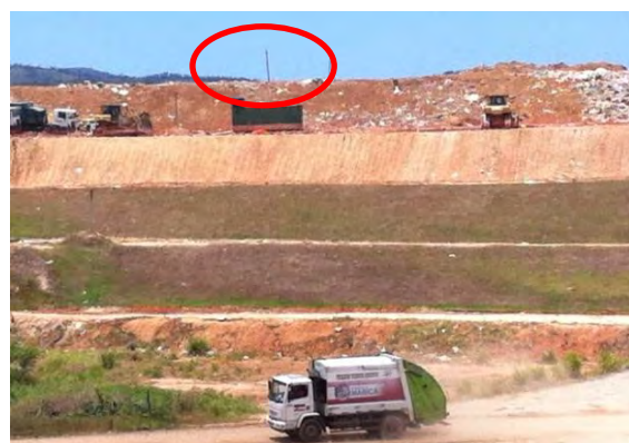
Figura 67: Coletor de gases no CGR Fonte: Conen
